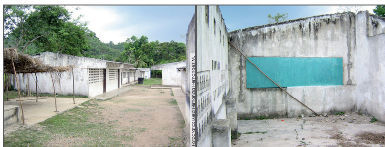
Instalaciones de la Institución Educativa Julio César Turbay (Macayepo). Varios salones se encuentran sin techo luego de que Acción Social les propusiera tumbarlos para instalar unos nuevos dentro del Plan de Retorno. En estas condiciones han estado los salones por tres años. Abril de 2009.
